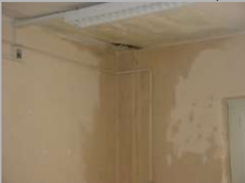
Fenomeni di infiltrazione nelle aule
