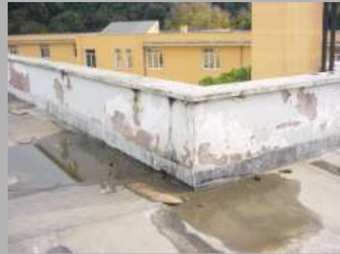
Ristagno di acqua in copertura
