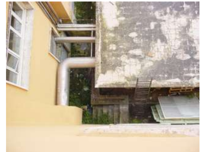
Locale della centrale del metano visto dall'alto
