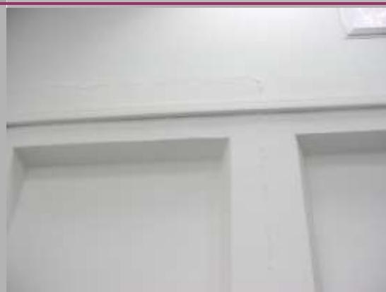
La crepa interna alla sala pranzo piccoli
