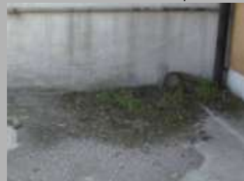
particolare con distacchi della tinta al quarzo plastico sul parapetto del tetto
