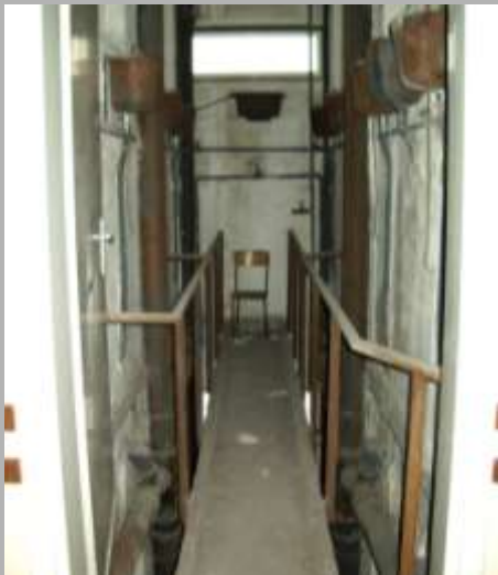
cavedio dell'impianto idrico
