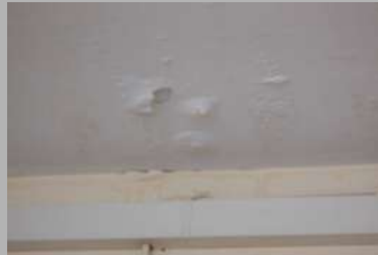
Infiltrazioni dal soffitto al secondo piano
