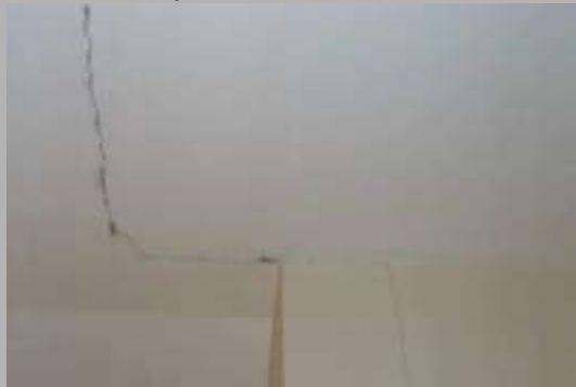
Distacco dell'intonaco sul giunto di dilatazione
