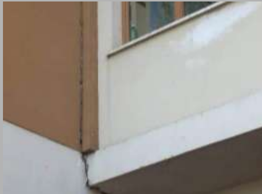
Distacco dell'intonaco sul giunto all'esterno
