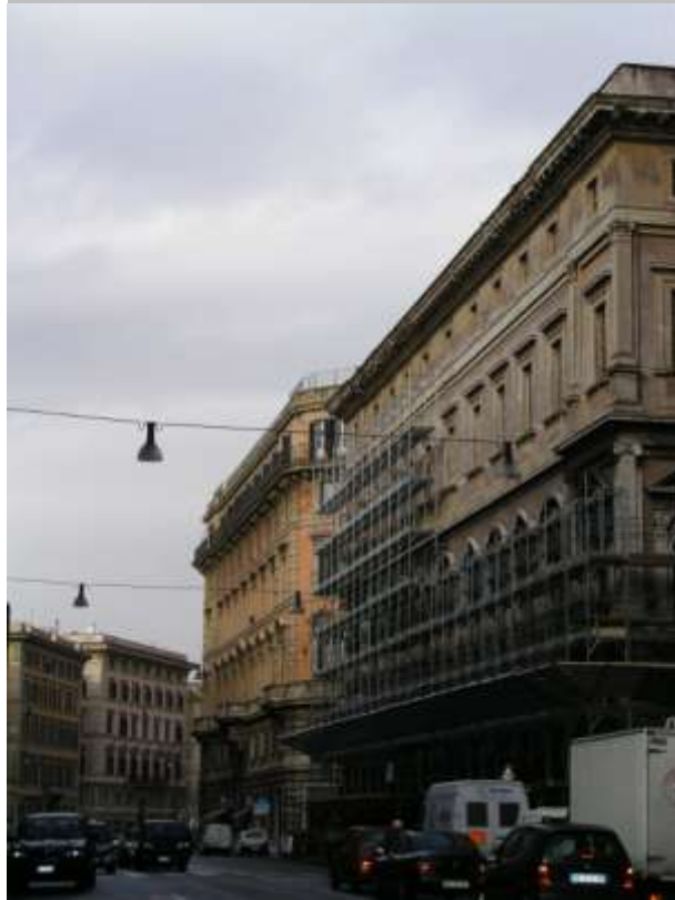
La facciata di Palazzo Fieschi Sora su Corso Vittorio Emanuele II. E' in corso la realizzazione del progetto di restauro e recupero previsto dalla Provincia di Roma
