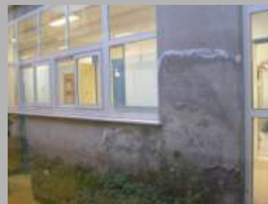
distacco dell'intonaco nel piccolo patio
