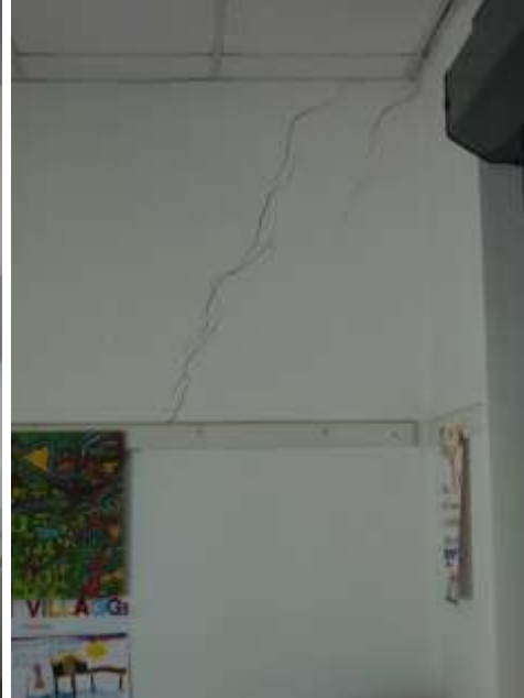
fessurazione passante nel muro
