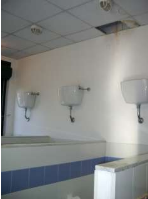
infiltrazione d'acqua nei bagni
