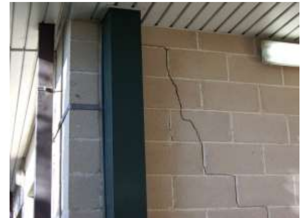
fessurazione passante nel muro
