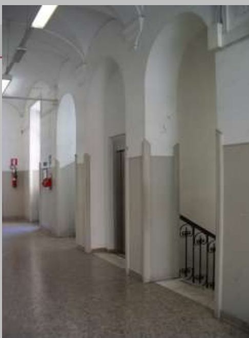
ascensore inserito all'interno delle scale- edificio originale
