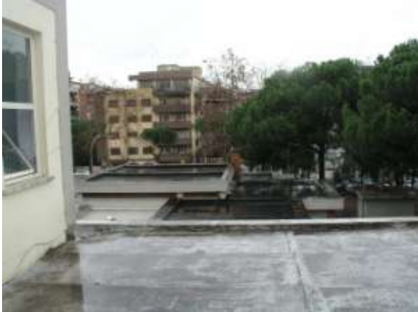
Stato di conservazione di alcuni spazi all'aperto (N/O): la scala di accesso alla quota della palestra; il passaggio e gli spazi intorno al prefabbricato della palestra; lo stato delle coperture (35) e sul fondo quelle della scuola dell'infanzia statale (35a)
