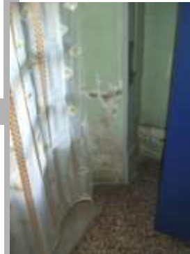
umidità di risalita nei muri della scuola per l'infanzia
