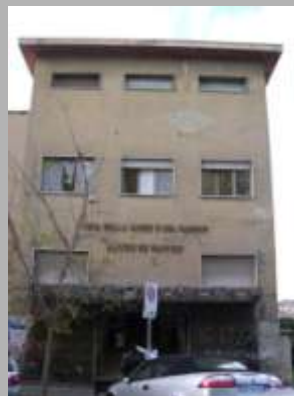
distacchi d'intonaco sopra l'ingresso
