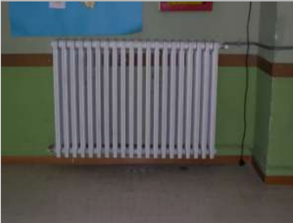
L'impianto elettrico con canalette in vista e i radiatori
