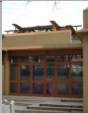
Particolare dell'entrata alla Scuola Materna: si nota il vuoto lasciato dalla scala d'accesso al terrazzo
