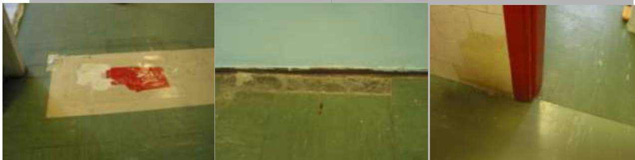
Parti del pavimento e del rivestimento che risultano ammalorate
