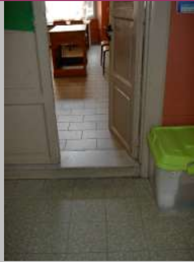
gradino tra corridoio e aula piano terra scuola dell'infanzia
