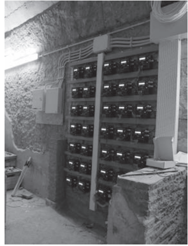
Fig. 6. Casa di Augusto al Palatino (Roma), 2012-14. La stanza chiusa al pubblico con i quadri elettrici, la centralina di controllo e i driver DMX; ogni driver ha tre canali; da ogni driver partono tre cavi bipolari per l'alimentazione e il controllo di ogni singolo apparecchio di illuminazione.
