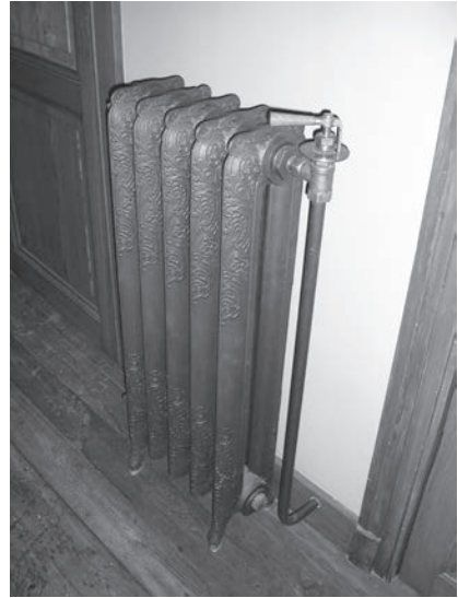
Fig. 4. Casa Horta, Bruxelles. Radiatore in ghisa, restaurato e rifunzionalizzato.
