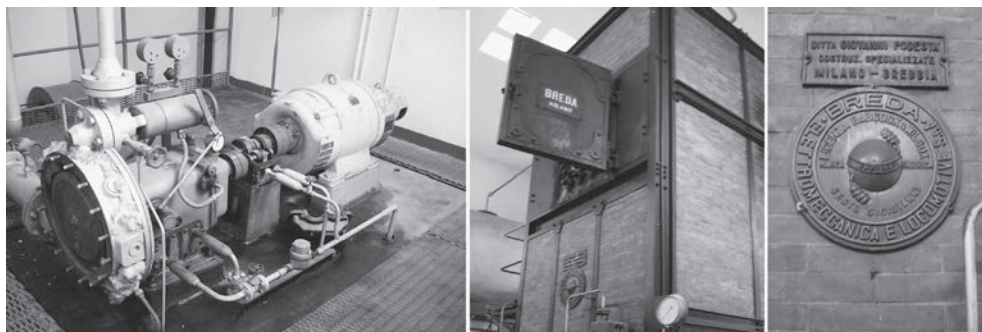
Fig. 7. Istituto Tecnico Industriale G. Marconi, Forlì. Il ‘fossile’ della centrale termica. Da destra: la turbina e l’alternatore; la caldaia; un dettaglio di produzione della caldaia con l’iscrizione “Breda Elettromeccanica e Locomotive S.p.a”.
