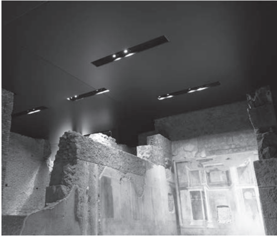
Fig. 5. Casa di Augusto al Palatino (Roma), 2012-14. Il controsoffitto della copertura in telo termoteso in PVC con le asole che alloggiavano i sistemi di illuminazione e altri impianti speciali.
