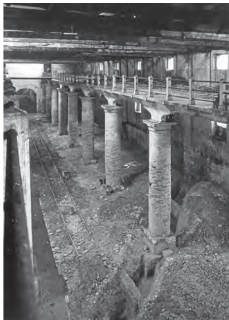
Fig. 6. Corderie. Ispezione per lo studio delle strutture di Fondazione (su concessione del Ministero dei Beni e delle attività culturali – SABAP-VE-LAG, n. 30591/1985).
