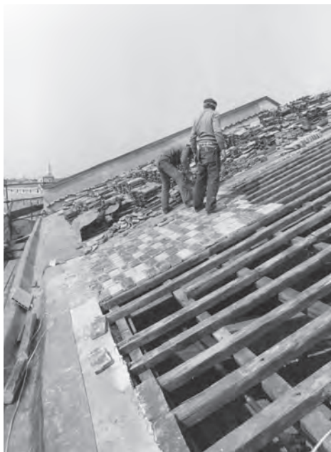
Fig. 3. Corderie. Lavori di restauro delle coperture (su concessione del Ministero dei Beni e delle attività culturali – SABAP-VELAG, n. 24637/1984).
