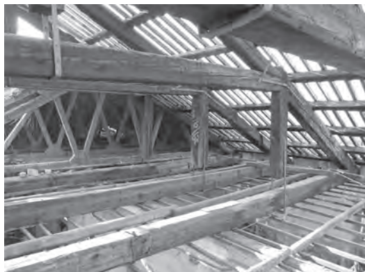
Fig. 5. Sale d'Armi. In primo piano le capriate alla palladiana in legno, in secondo piano quelle in calcestruzzo armato (foto C. Menicelli 2007).
