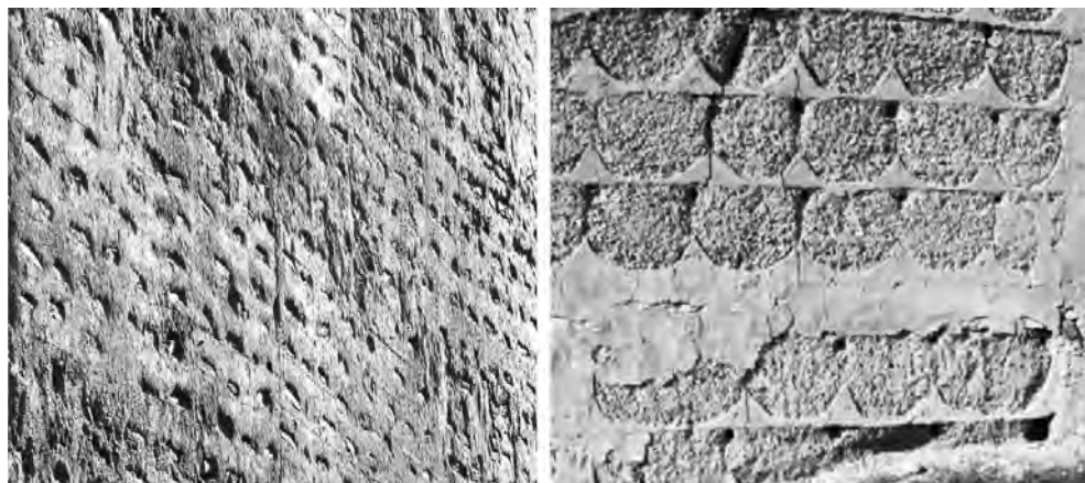
Fig. 2. Sulla sinistra, immagine di una muratura in 'tapia valenciana', costruita con pisé e laterizio e ricoperta in superficie con malta di calce. Sulla destra, muratura in pisé con rinforzi di malta di gesso.
