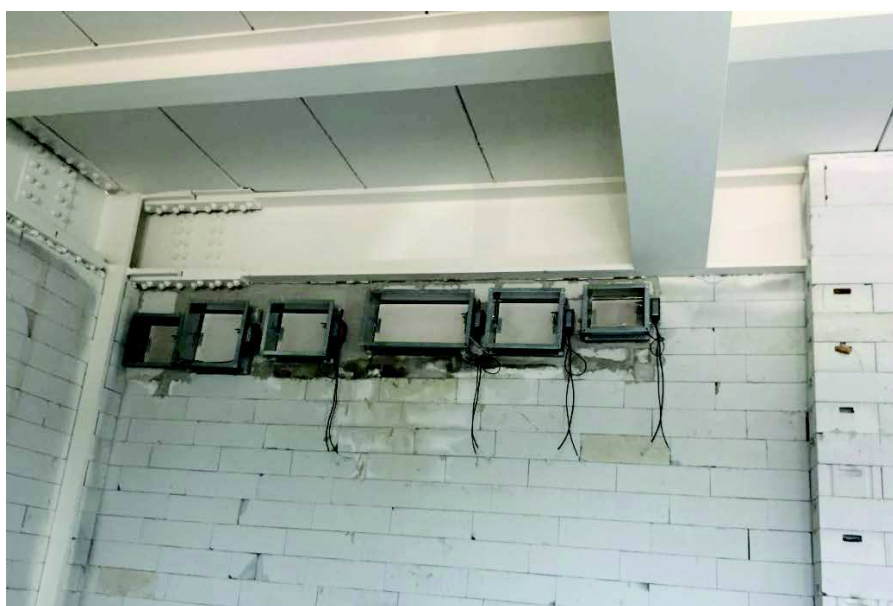
Predisposizione delle canalizzazioni di mandata, ripresa e estrazione - interno
