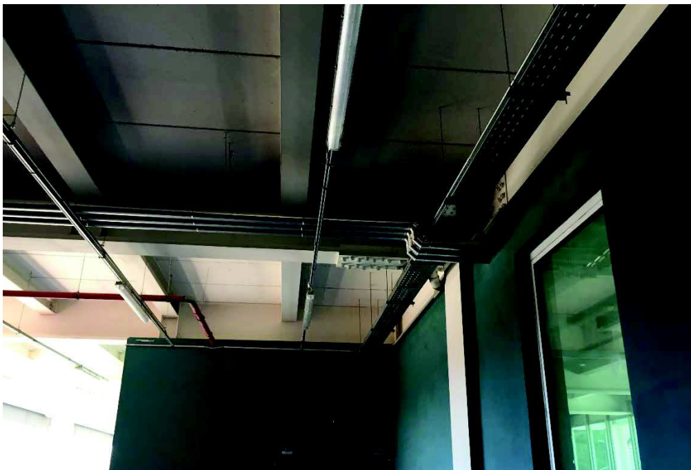
Approdo delle tubazioni lungo la parete esterna sud
